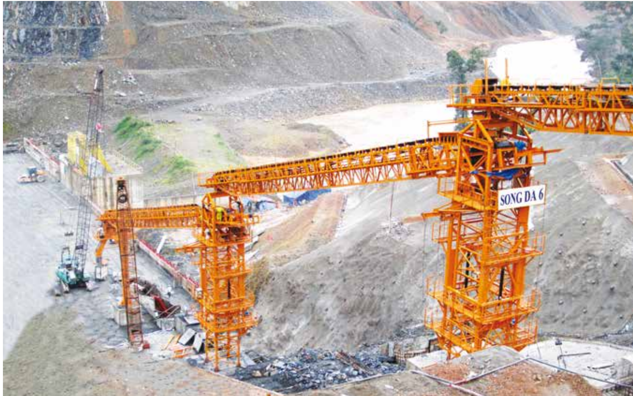
Hệ thống băng tải bê tông tại công trình thủy điện đồng nai 5
